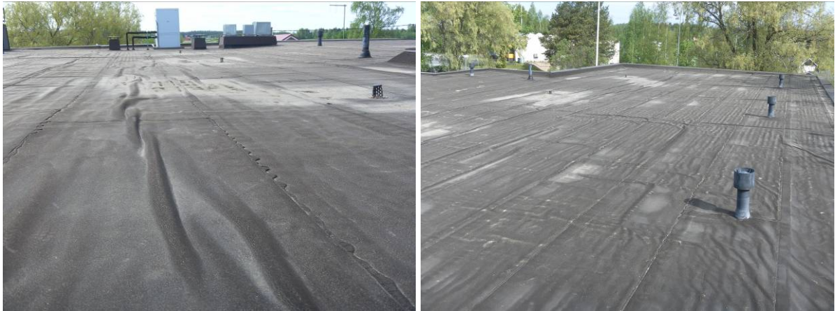
Kuva 8. Vesikatto oli kunnantalon kohdalla voimakkaasti laineilla. Vettä oli jälkien mukaan lammikoitunut melko laajoilla alueilla.
