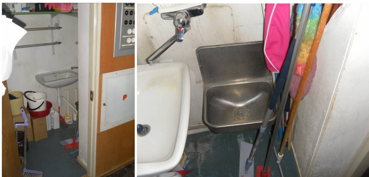
Kuva 17. Pääaulan siivousskomeron lastulevypinnat olivat kosteusvaurioituneet.
