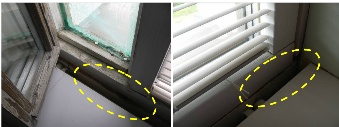
Kuva 15. Asuttopuolen ikkunoiden alapuolisissa lastulevyissä oli useita kosteusvauriokohtia.
