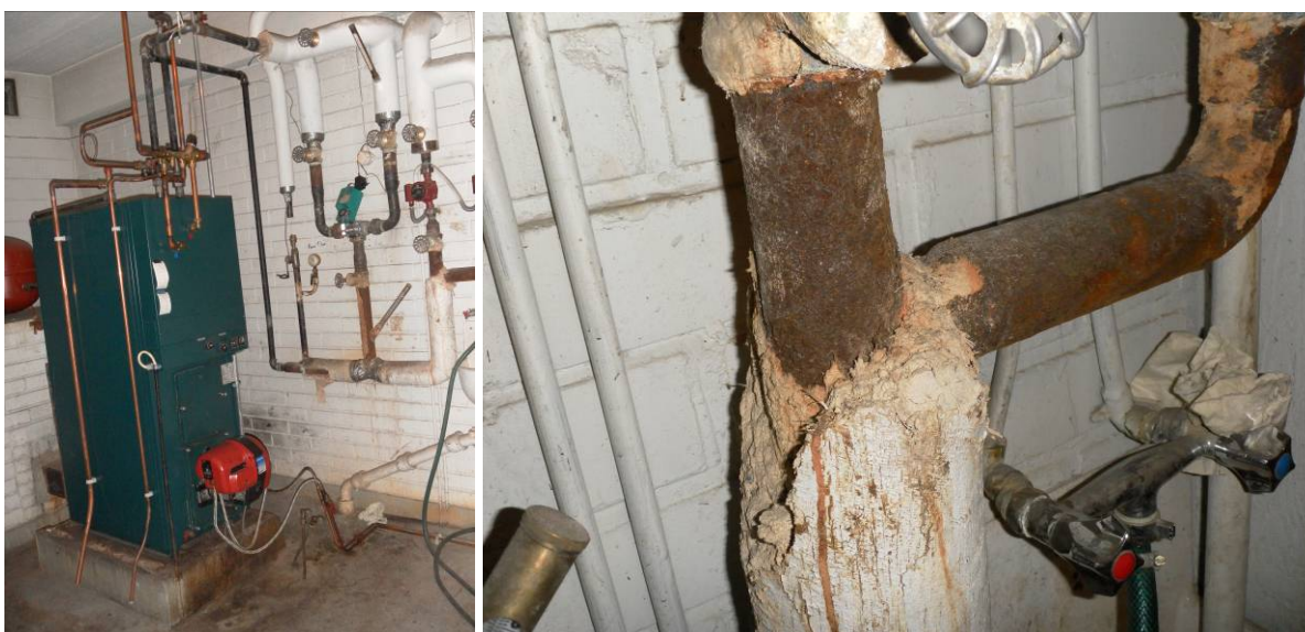
Kuva 19. Lämmityskeskus öljysäiliöineen on uusittu. Putkistot ovat kuitenkin pääsoin alkuperäiset. Putkieristeet sisältävät asbestia, mikä on huomioitava korjaus- ja muutostöissä.
