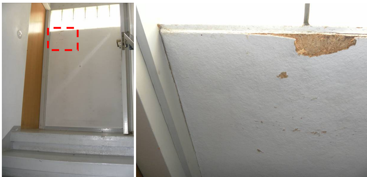
Kuva 14. Eteläpään portaikon kohdalla olevat lasitiili-ikkunat ovat vuotaneet ja alapuolinen lastulevy on vaurioitunut. Myös seinässä olevan Toja-levyn vaurioituminen on todennäköistä.
