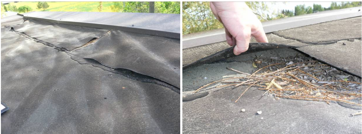
Kuva 9. Räystäällä huovat olivat paikoitellen auenneet liitoksistaan.
