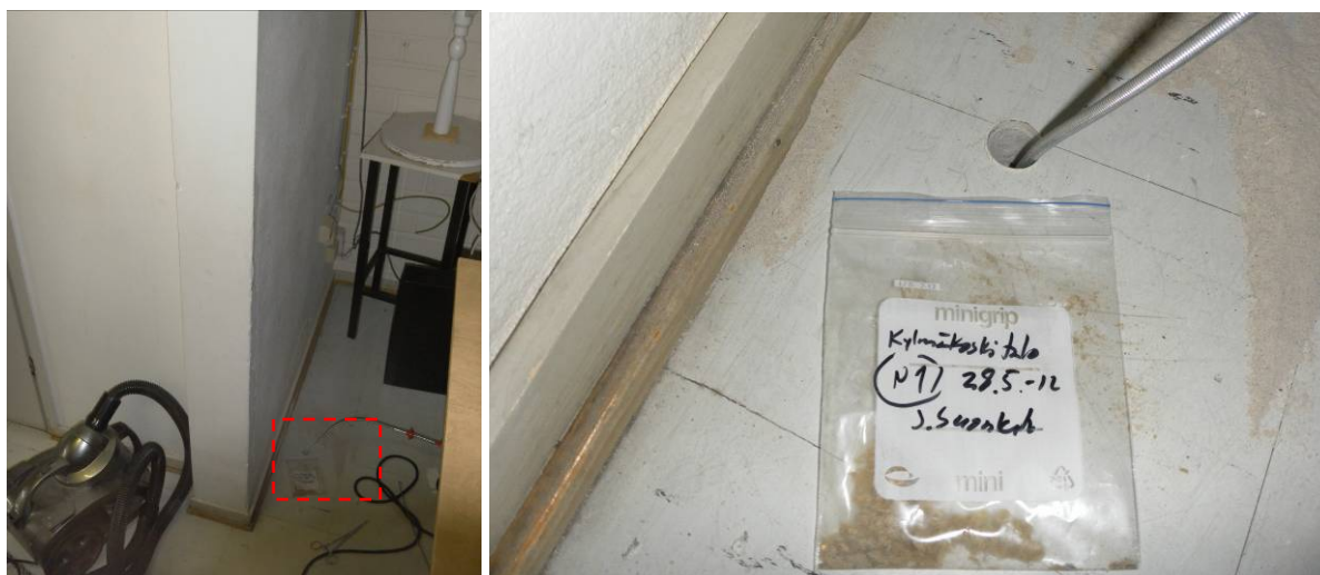
Kuva 3. Materiaalinäyte N1 välipohjan sisällä kulkevien putkilinjojen eristeenä olevasta kivivillasta. Viereisen wc-istuimen kohdalta on tapahtunut vuotoa. Näytteessä todettiin kohtalaista kosteusvauriota indikoivan ja mahdollisina toksiinien tuottajina pidettyjen aknomykeettien (sädesienet) kasvua. Näyte osoitti viitearvon ylittävää mikrobikasvua.
