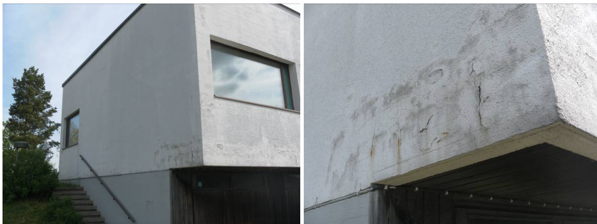
Kuva 11. Kellarin päällä olevan seinäulokkeen kylmässä alareunassa oli laajaa pakkasrapautumaa ja lohkeilua.
