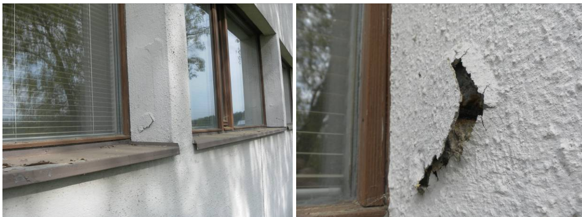
Kuva 10. Kenitex-pinnoitetun betonipinnan vaurioita.
